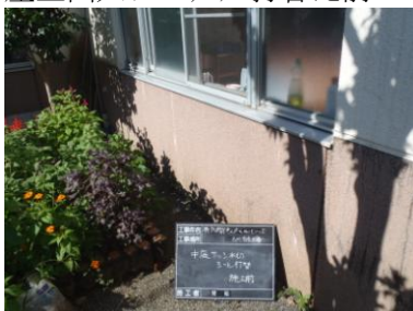
中庭サッシ水切り目地シーリング 打替え前
