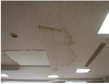
天井岩面吸音板張替前
