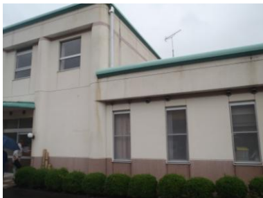
外壁クラック処理前
