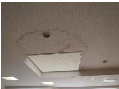
天井岩面吸音板張替前
